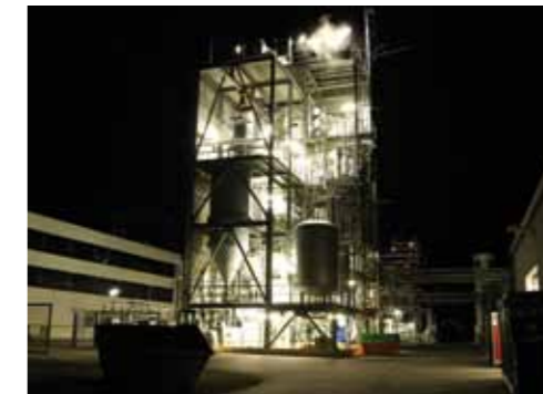
Die Pilotanlage des Schlackebadvergasers am Standort Freiberg wird in enger Kooperation mit dem Institut für Energieverfahrenstechnik und Chemieingenieurwesen der TU Bergakademie Freiberg betrieben. Die Anlage wird für Tests mit verschiedenen festen Kohlenstoffträgern wie z. B. Biomasse und kunststoffhaltigen Abfällen genutzt.
